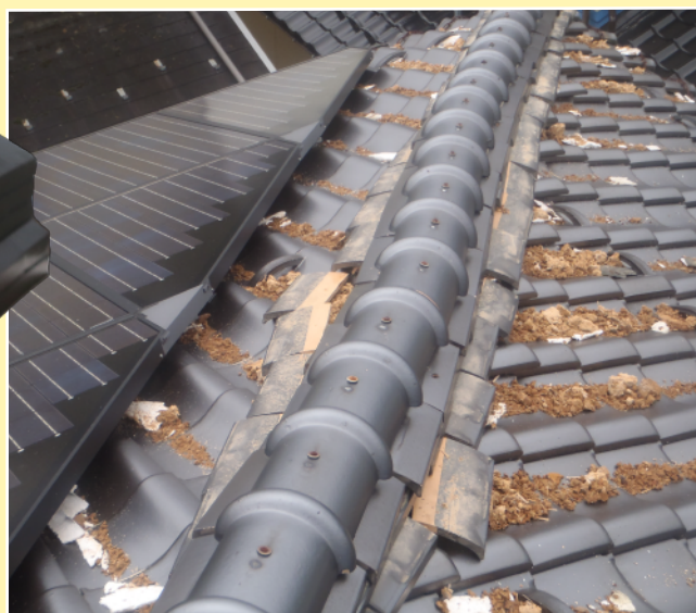
地震でゆがみ、崩れた棟
